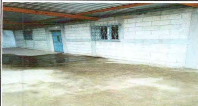
Foto1: Cocina necesita pintura
