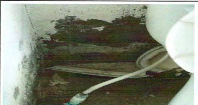
Foto 3: Tasas de baño quebrados
