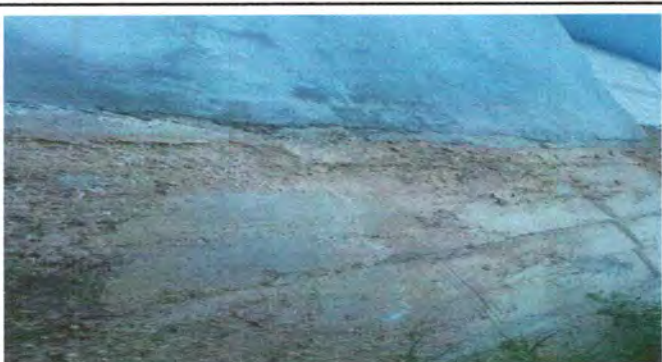
Foto 9: Muro de contención necesita repello y cernido.
