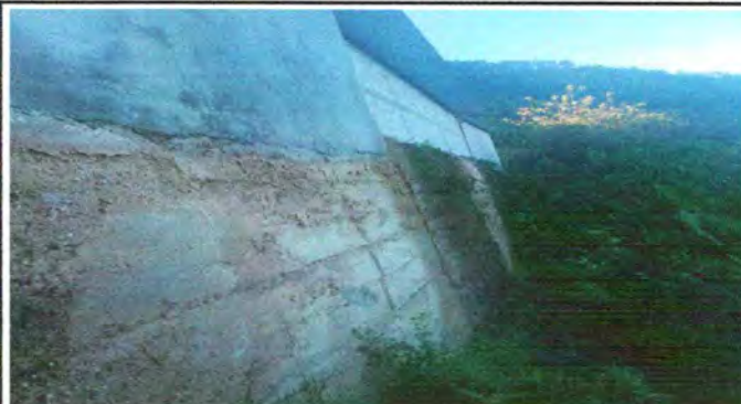
Foto 8: Penetración de humedad en espacios no repellados.
