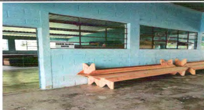
Foto 7: Aulas necesitan balcones y pintura.
