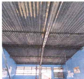
Foto 2: Soporte de metal en aula 3 del módulo 1.
