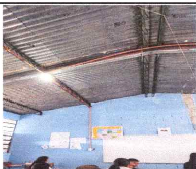
Foto 5: Instalación eléctrica del aula 3, módulo 1.
