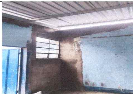
Foto 3: Repello en paredes interiores del aula.
