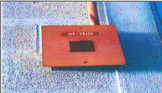
Foto 16: TABLEROS Y FLIPONES DE BAJA CAPACIDAD
