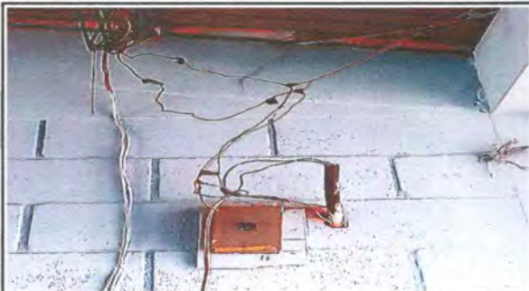
Foto 13: CABLEADO CON CONEXIONES INCORRECTAS
