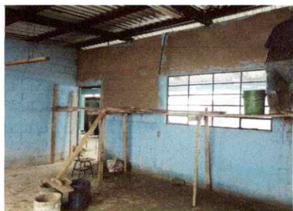
Foto 11: repello en cocina
