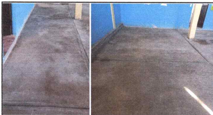
Foto 3: Torta de cemento reparado
