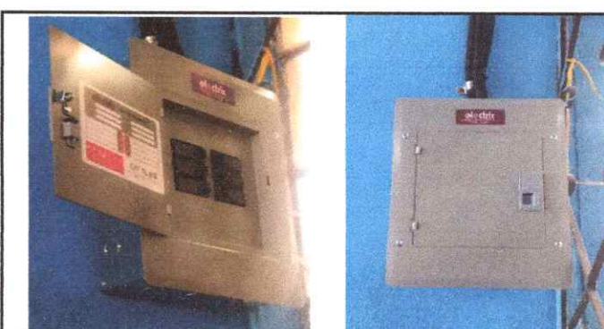
Foto 6: Sistema electrico finalizado
