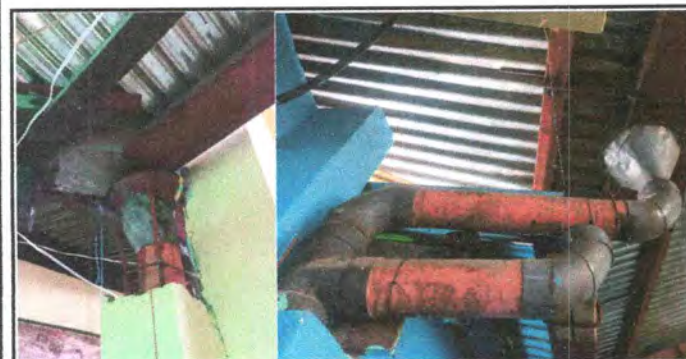
Foto 5: Daño en canales y bajadas de agua
