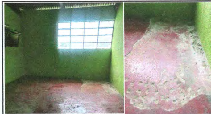
Foto 4: Piso de cocina en mal estado es necesario sustituirla por piso de granito
