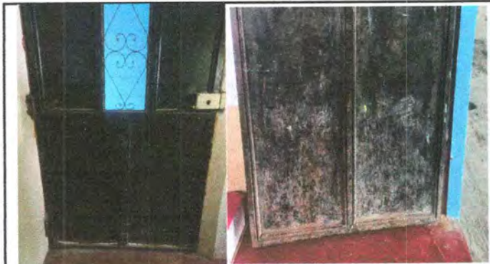
Foto 1: Daño en puertas de aulas, cocina y dirección
