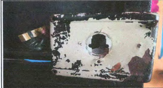
Foto 2: Chapas de puertas de aulas deterioradas
