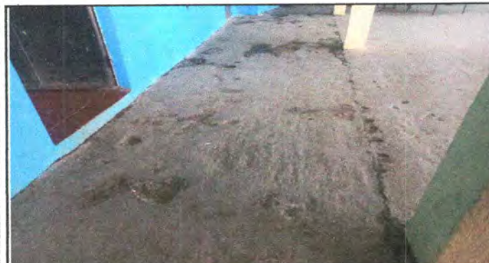
Foto 3: Daño en torta de cemento por agujeros
