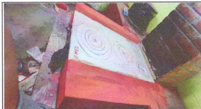
Foto 9: Plancha de tres hornillas instalada
