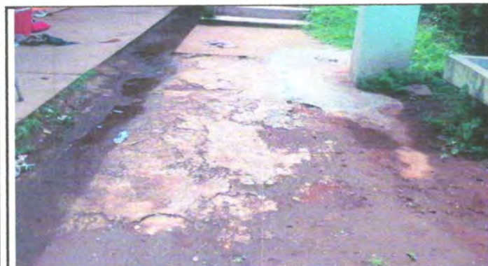
Foto 3: Planchas de concreto de patio dañados
