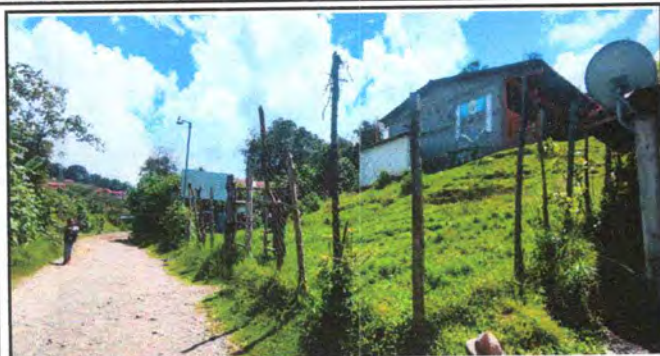
Foto 7: Cerco perimetral de malla con postes de madera quebrados y deteriorados
