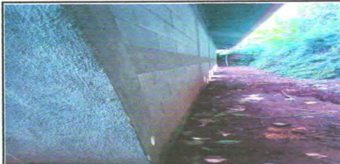
Foto 2: Penetración de humedad en espacios no repellados
