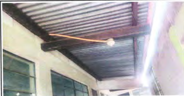
Foto 14: Plafoneras y focos inservibles
