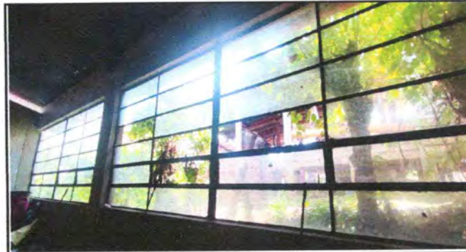
Foto 10: Vidrios de aulas quebrados
