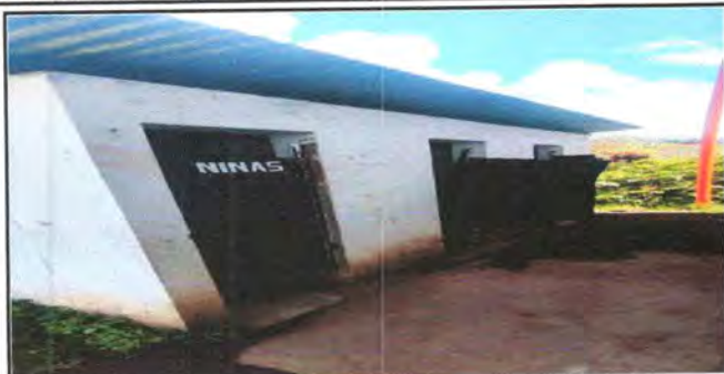
Foto 13: Puertas de servicios sanitarios desprendidas y oxidadas
