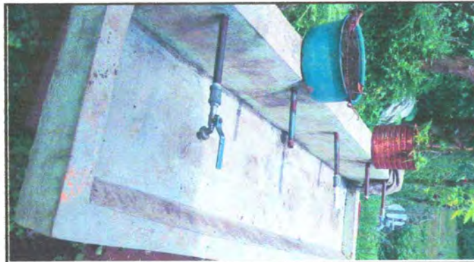
Foto 4: Llaves de chorros dañados
