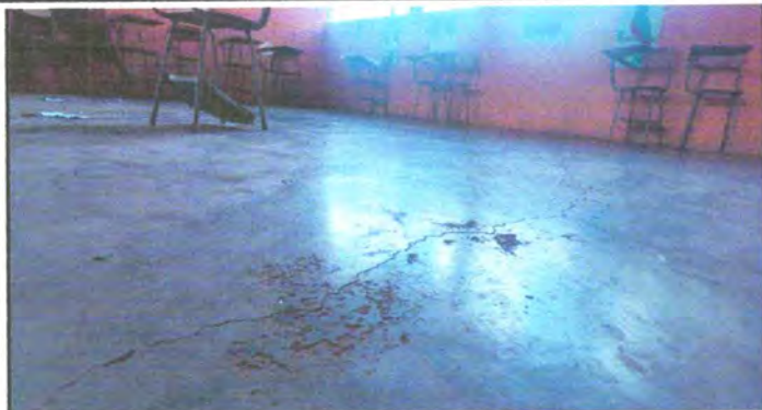
Foto1: Piso de torta de concreto obsoleto
