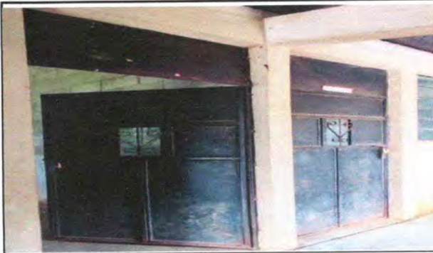
Foto 8: Puertas de aula oxidadas
