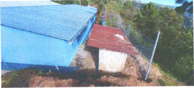
Deterioro del techo de toda la escuela
