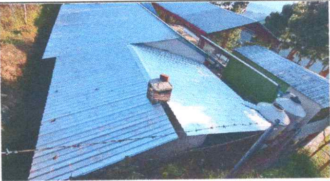
Deterioro del techo de la cocina
