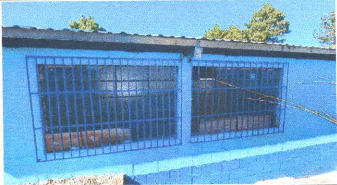
Balcones prefabricados por padres de familia y en mal estado
