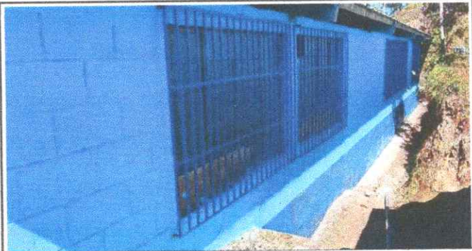
Pintura de paredes descoloridos
