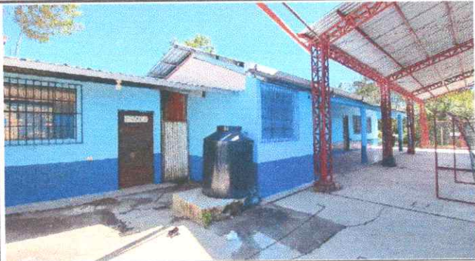
Deterioro del techo de toda la escuela
