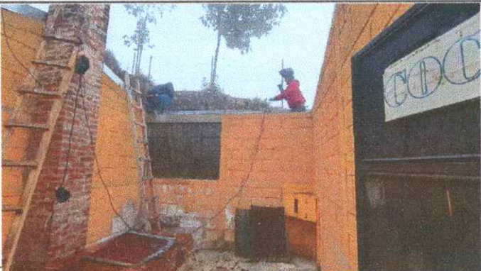
Deterioro del techo de la cocina
