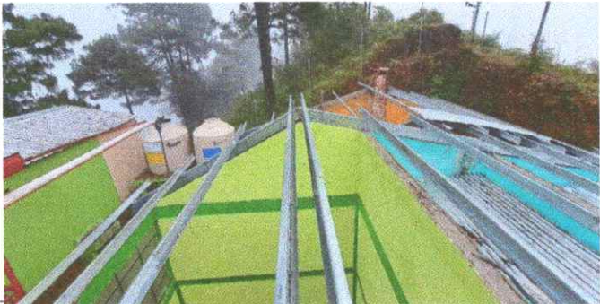
Deterioro del techo de toda la escuela
