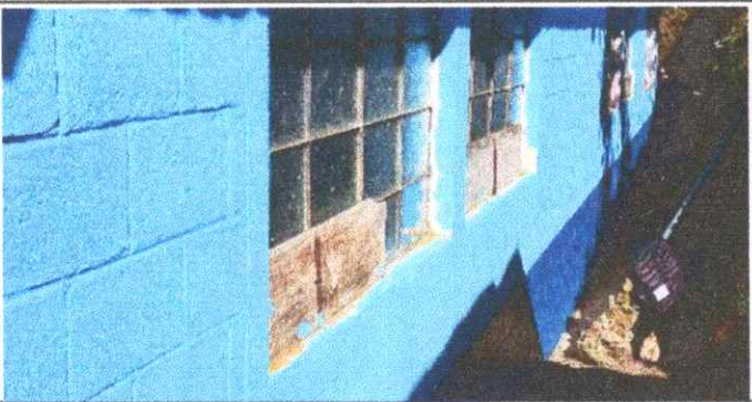
Pintura de paredes descoloridos
