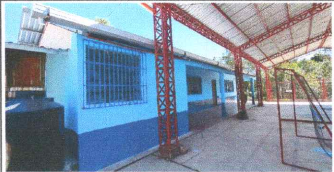
pintura deteriorada y balcones hechos por padres de familia con pedazos de hierros
