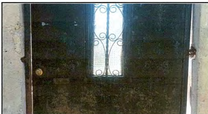
Foto 3: puerta metalica deteriorada
