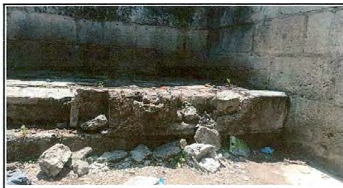
Foto 4: estructura de estufa rural en mal estado
