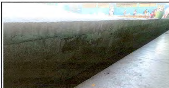
Foto 5: muro de contención a punto de desplomarse
