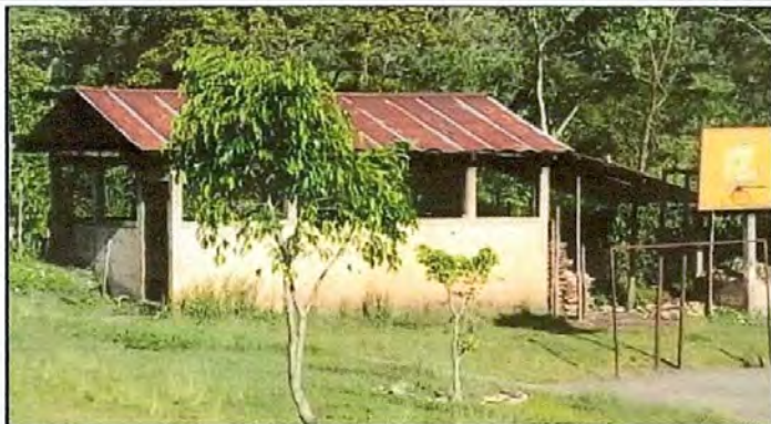
Foto 1: laminas de techo en mal estado
