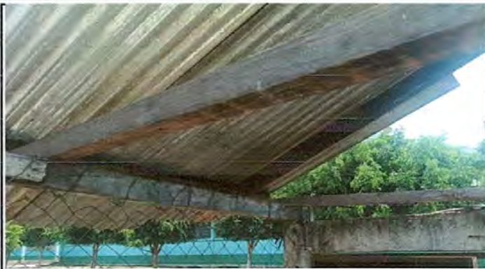
fotografía 7: estructura portante de madera en mal estado
