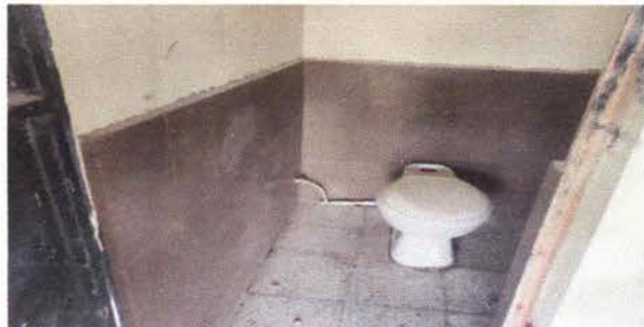
Foto1: Piso de baño para hombres instalado adecuadamente
