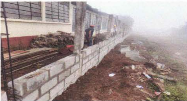
Foto 3: Avance significativo de la pared del muro
