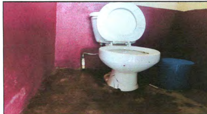
Foto 4: Sanitarios en muy mal estado.
