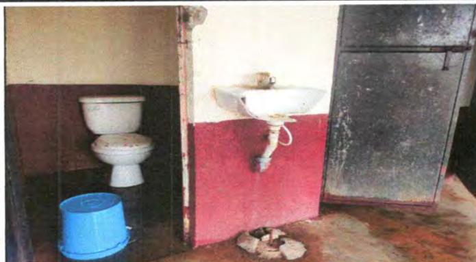
Foto1: Servicios sanitarios en muy mal estado.
