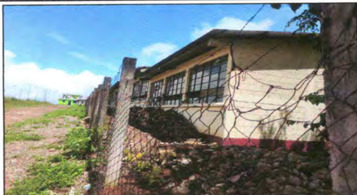
Foto1: Circulación deteriorada por el paso del tiempo.
