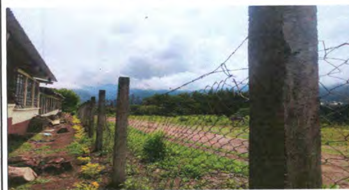
Foto 5: Malla deteriorada que necesita reconstrucción.
