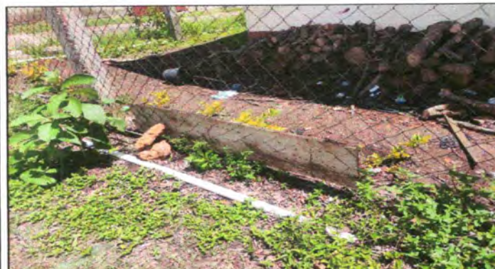
Foto 3: Malla deteriorada por el paso del tiempo.
