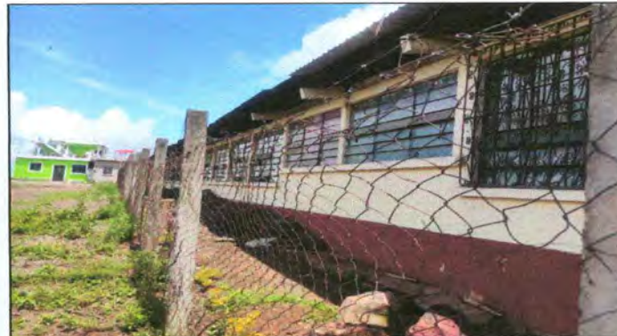
Foto 4: Malla en malas condiciones.
