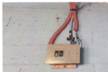
Foto 4: Rama eléctrica, sin energía desde hace 7 meses.
