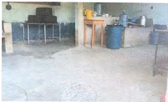
Foto 9: Piso de cocina arietado, con desprendimiento.
