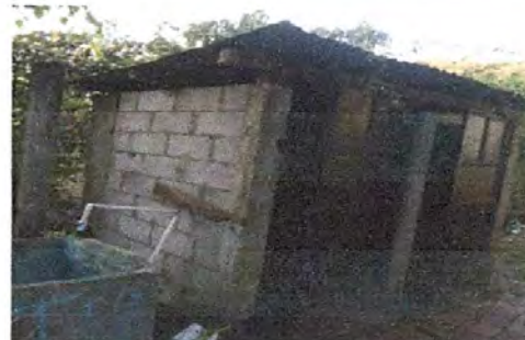
Foto 6: Puertas de metal en baños en mal estado.
