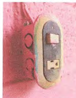
Foto 8: Instalación eléctrica en baños en mal estado.
