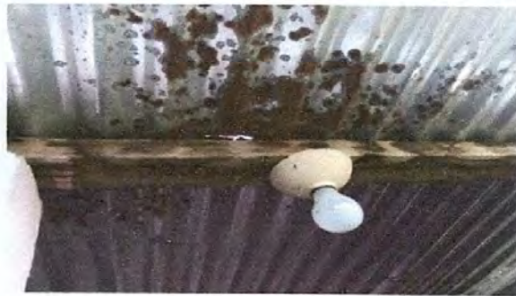
Foto 3: Estructura de soporte de madera, en techo de baños en mal estado.
