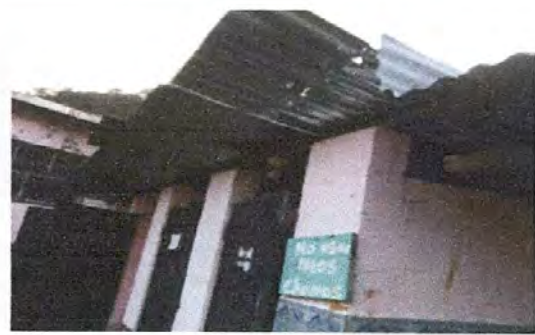
Foto 2: Lámina de baños en mal estado.
