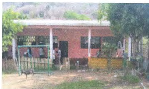
Foto 10: Pintura en muro exterior en mal estado.
