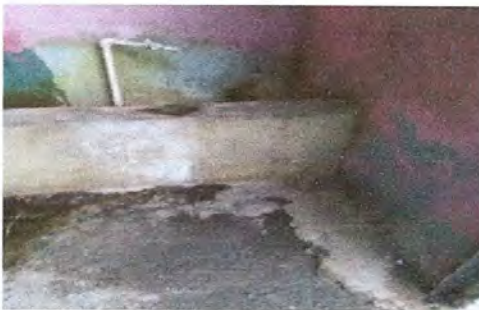
Foto 5: Migitorio en mal estado.
