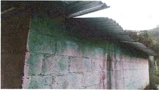
Foto 1: Muro de módulo de baño con grietas.
