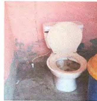
Foto 4: Inodoros en mal estado.
