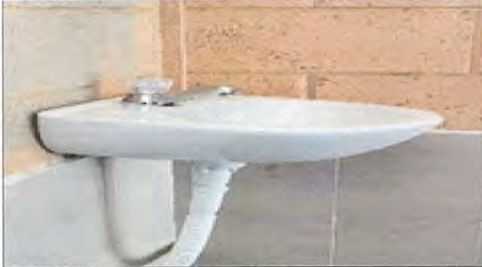
Foto 1: Lavamanos instalado en los baños
