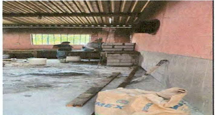
Foto 2: sustitución de muebles por muebles de cemento
