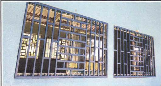
Foto 3: Las ventanas de las aulas están totalmente cambiadas.
