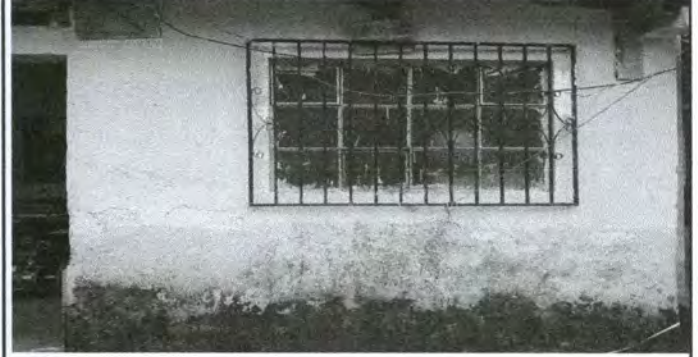
Foto 4: Las ventanas tienen balcones deteriorados.
