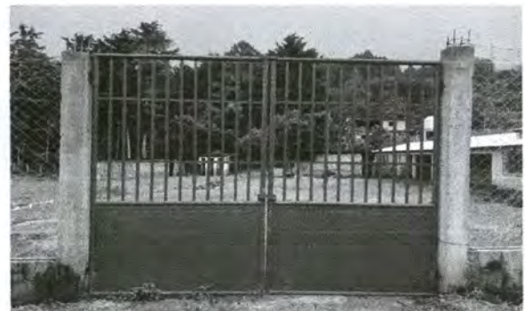
Foto 2: El portón necesita protección por estar a la intemperie, expuesto a los rayos del sol y lluvias.
