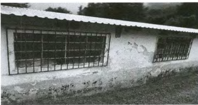
Foto 3: Las ventanas de las aulas tienen vidrios quebrados.
