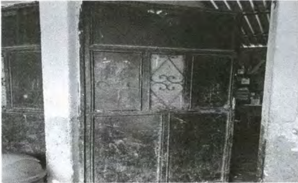
Foto 1: Las puertas de metal se encuentran corroidas.
