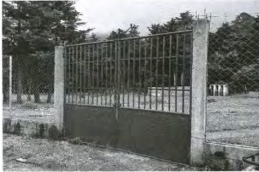
Foto 1: El portón necesita mantenimiento.
