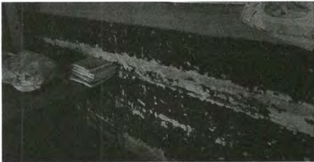
Foto 5: La pintura en paredes interiores esta deteriorada.
