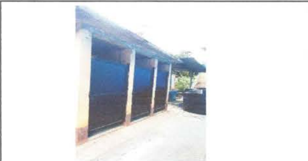
Foto 11: Servicio sanitario en puertas.
