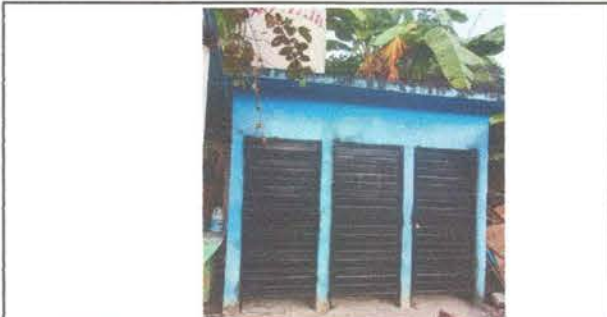
Foto 12: Servicio sanitario en puertas.
