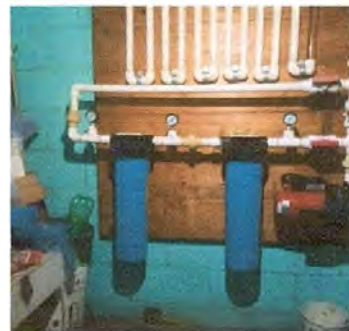
Foto 6: MANTENIMIENTO FILTROS AGUA PURIFICADA
