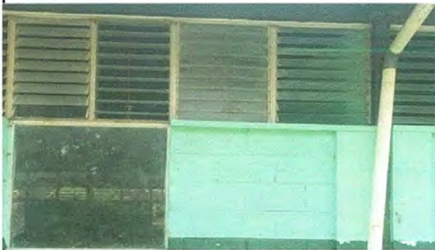
Foto 3: SUTITUCIÓN DE VIDRIOS QUEBRADOS
