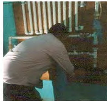
Foto 6: CAMBIO DE FILTROS
