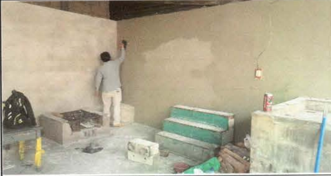
Foto 6:Repello en muro deteriorado
