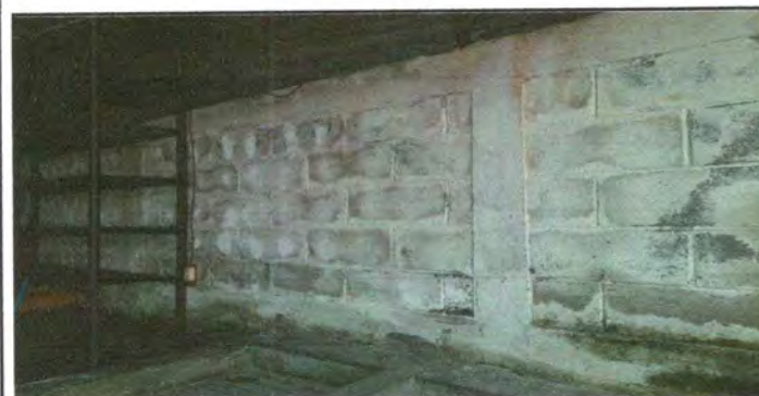
Foto 17: Repello en muro deteriorado
