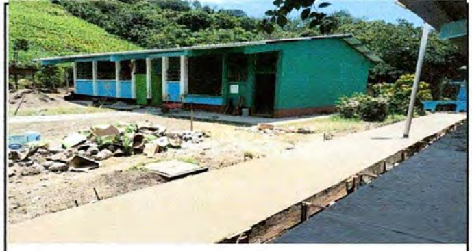
Foto 8: Plancha de concreto de patio
