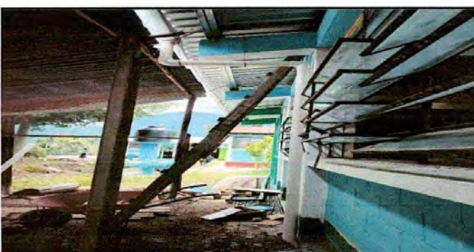
Foto 6: Bajada de agua pluvial, tubo PVC 3"
