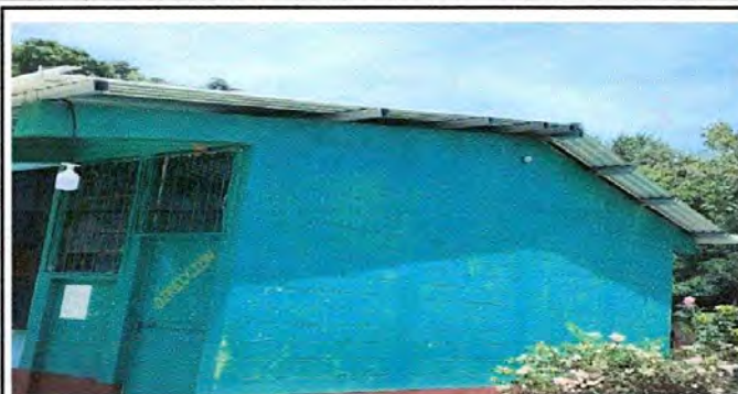
Foto 2: estructura de soporte de metal por metal
