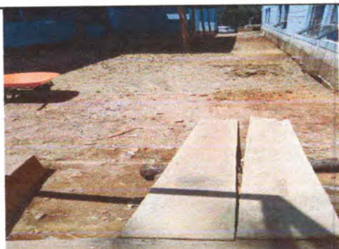
Foto 5: Cambio de corredor por pavimento
