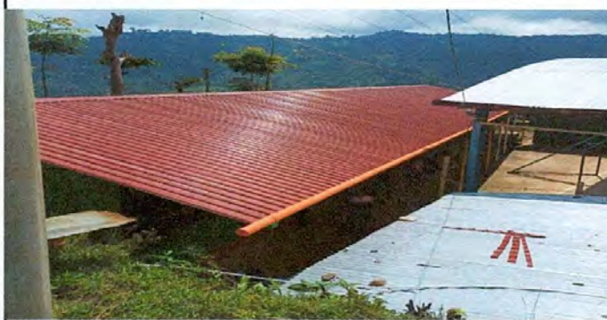
Foto 1: lámina en malas condiciones
