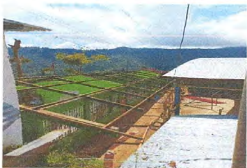
Foto: 1 Laminas en malas condiciones.
