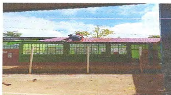
Foto: Laminas en malas condiciones.
