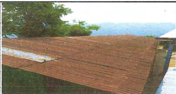
Foto 1: lámina en malas condiciones
