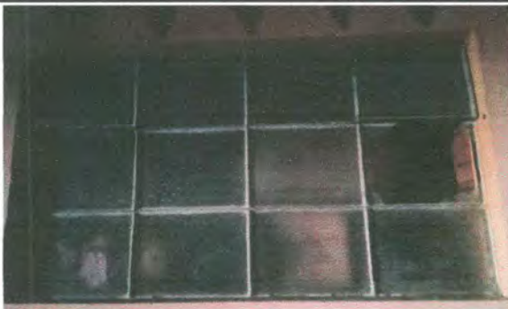
Foto 9: VIDRIOS DE VENTANAS QUEBRADAS
