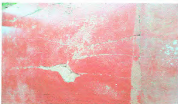
Foto 3: PISO EN MAL ESTADO DE AULAS Y CORREDOR
