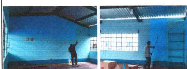
Foto 4: Pintura de paredes exteriores e interiores de las aulas de la escuela debido al mal estado en que se encuentran.
