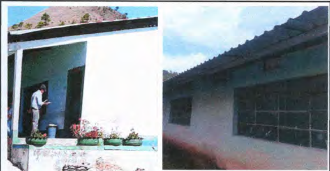
Foto 4: Pintura de paredes exteriores e interiores de las aulas de la escuela debido al mal estado en que se encuentran.
