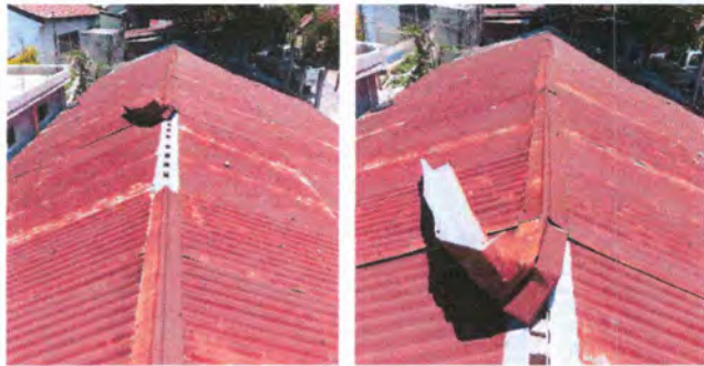
Foto1: El techo de las aulas se encuentra en mal estado, se filtra el agua, por lo que se tiene contemplado la reparación de costaneras y sustitución de laminas.
