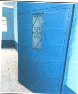
Foto 3: PUERTAS DE METAL
