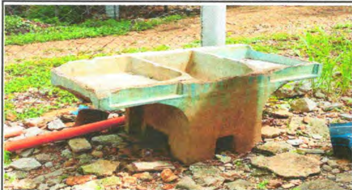
Foto 7: Pila en malas condiciones.
