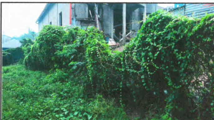
Foto 4: muro perimetral, malla en mal estado
