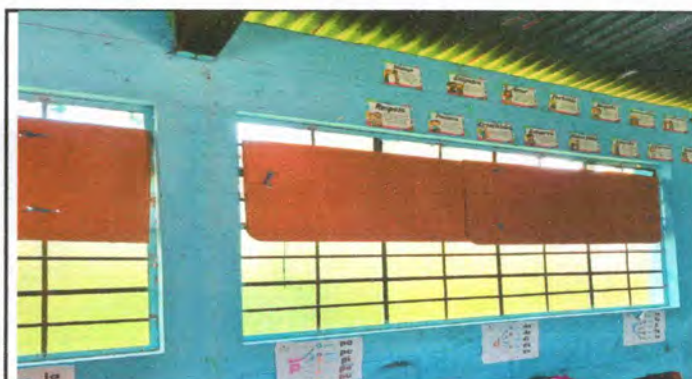
Foto2: ventana con vidrios rotos, vista interior
