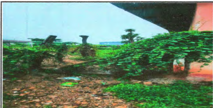
Foto 5: muro perimetral, malla en mal estado
