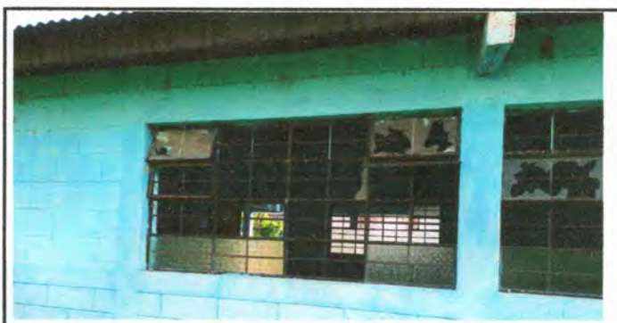
Foto 4: ventana con vidrios rotos
