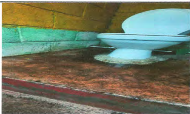
Foto 3: fuga en inodoro
