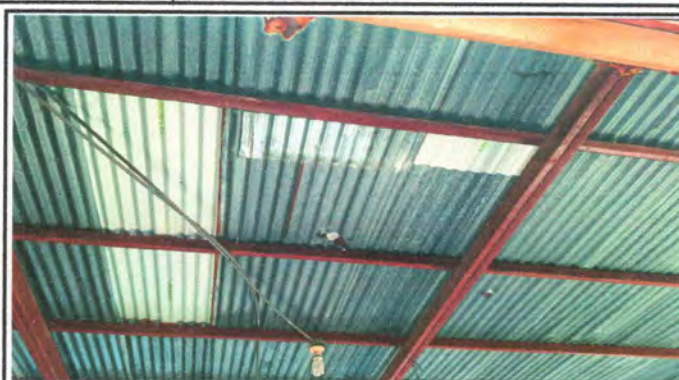
Foto 2: vista interior del aula con techo roto
