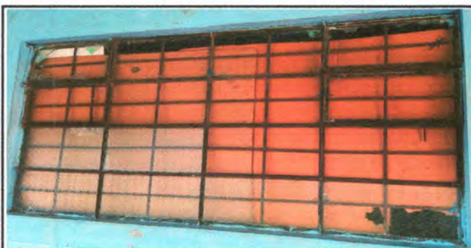
Foto 3: ventana con vidrios rotos, vista exterior
