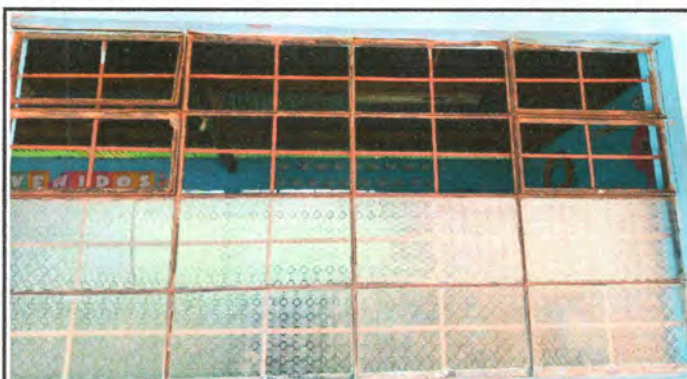
Foto1: ventana con vidrios rotos, vista exterior
