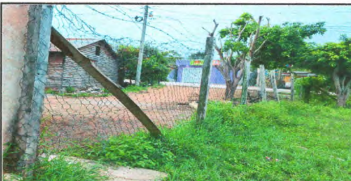
Foto 6: muro perimetral, malla en mal estado
