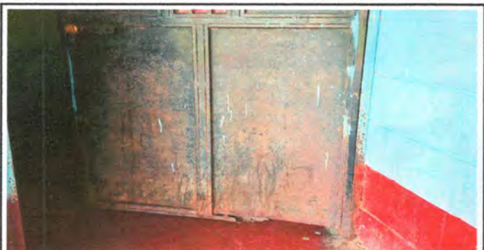
Foto 1: puerta de direccion en mal estado
