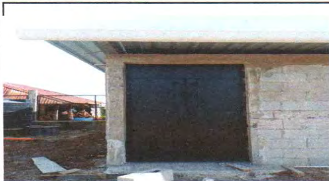
Foto 1: Puertas de metal
