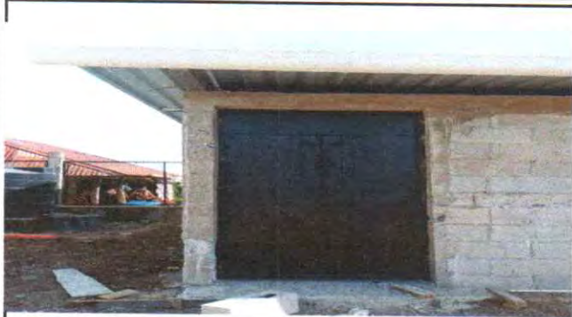
Foto1: Puertas de metal
