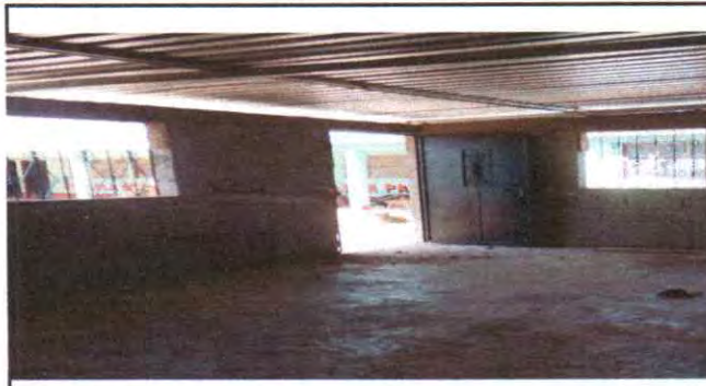
Foto 2: Puertas de metal
