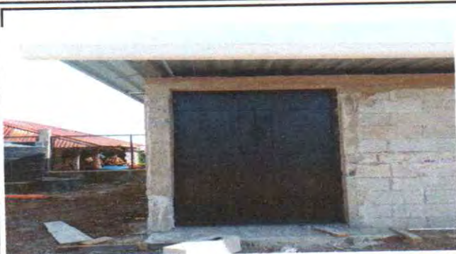
Foto1: Puertas de metal
