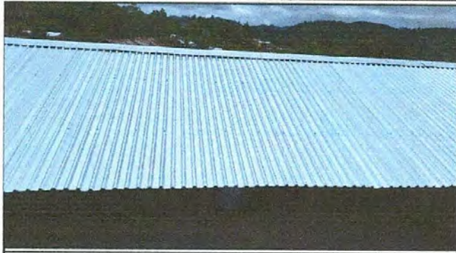
Foto 1: Techo en malas condiciones.
