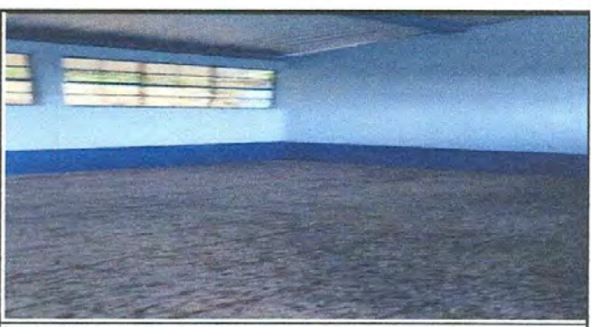
Foto 6: Piso en malas condiciones.
