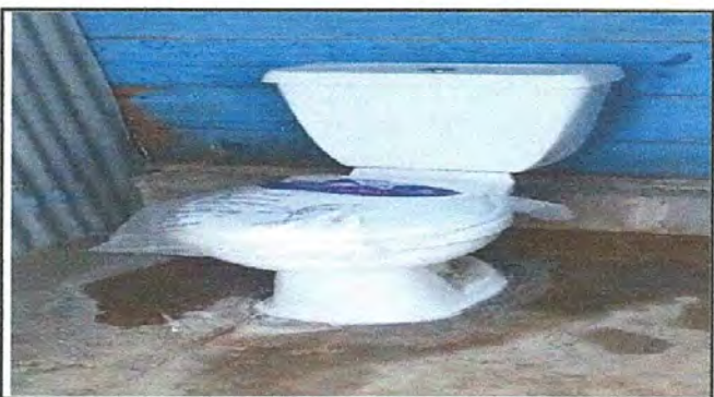
Foto 4: Baño en mal estado.
