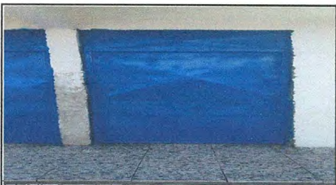
Foto 5: Puerta en mal estado.
