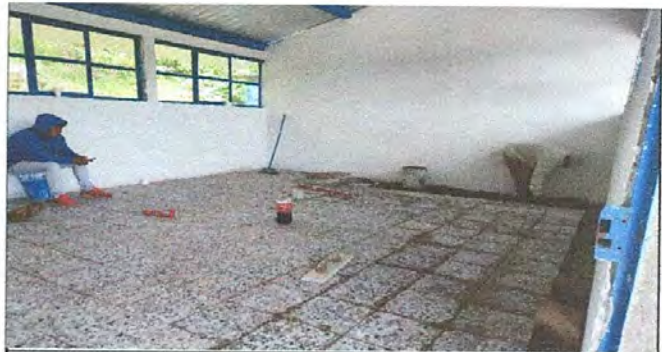
Foto 6: Piso en malas condiciones.
