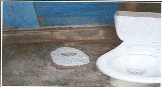
Foto 4: Baño en mal estado.
