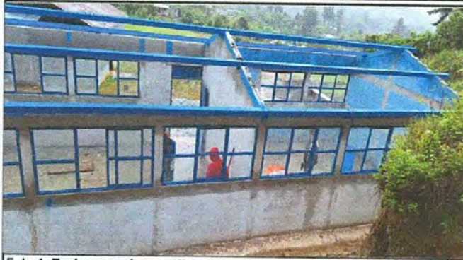
Foto 1: Techo en malas condiciones.
