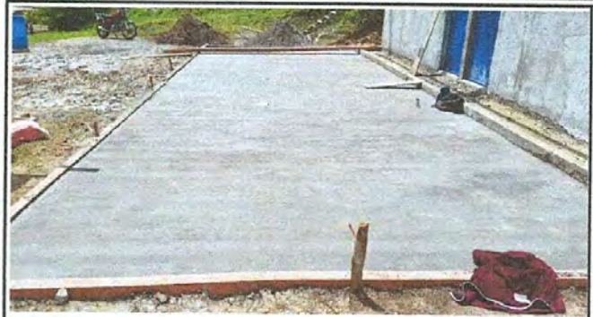
Foto 2: Losa de patio en mal estado.
