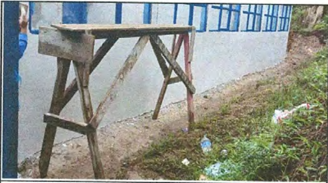
Foto 3: Muro perimetral en malas condiciones.
