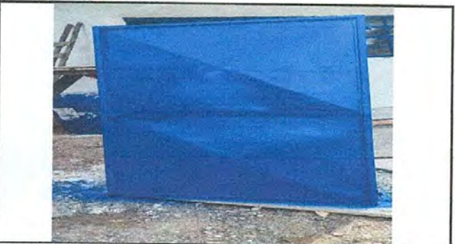
Foto 5: Puerta en mal estado.
