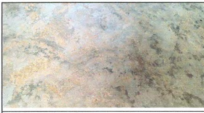
Foto 6: Piso en malas condiciones.
