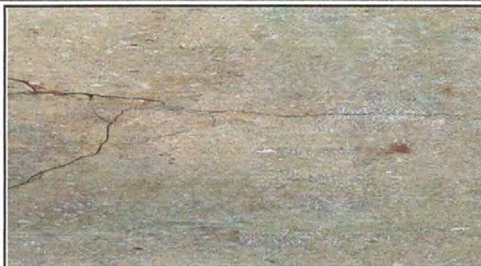
Foto 2: Losa de patio en mal estado.
