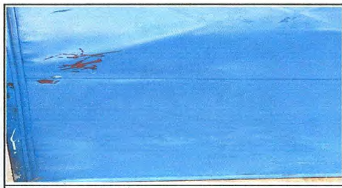
Foto 5: Puerta en mal estado.
