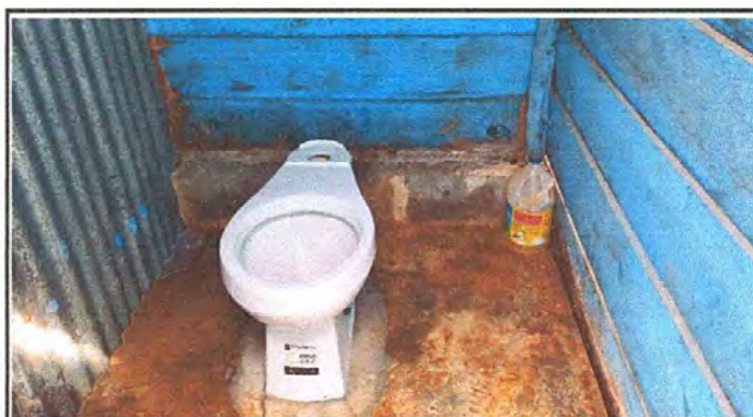
Foto 4: Baño en mal estado.
