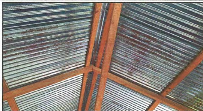
Foto 1: Techo en malas condiciones.
