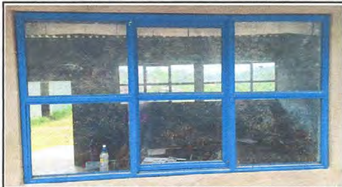
Foto 7: Estructura de metal en malas condiciones.
