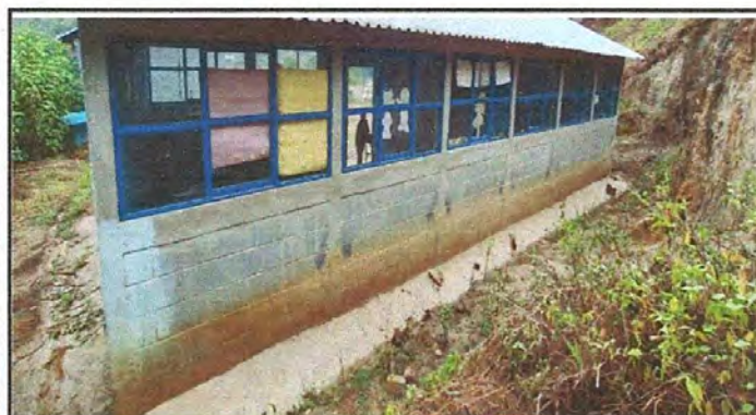
Foto 3: Muro perimetral en malas condiciones.
