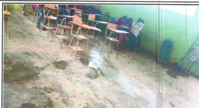
Foto 2: Piso en malas condiciones.
