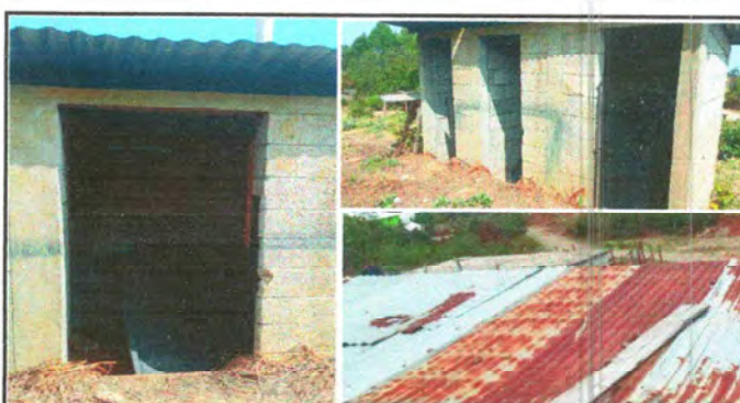
Foto 4: Sanitarios en malas condiciones.
