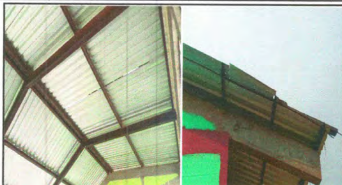
Foto 1: Techo en malas condiciones.
