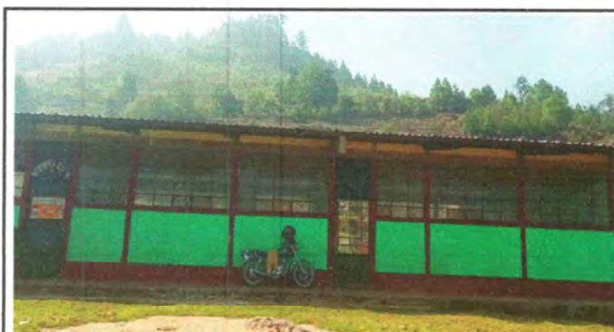
Foto 3: Repello en malas condiciones.
