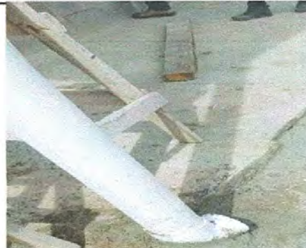
Foto 4: CANALES Y BAJADA DE AGUA PLUVIAL
