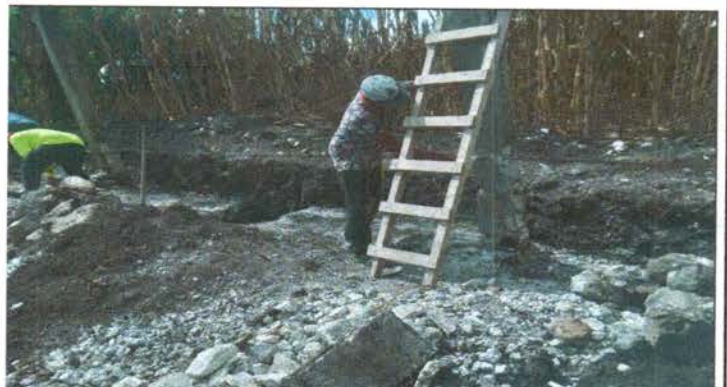
Foto 4: Muro perimetral deteriorado
