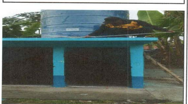
Foto 6: Rotoplast y pila en mal estado
