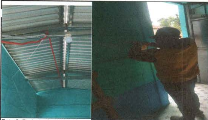
Foto 5: Red de electricidad en mal estado
