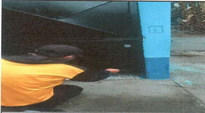
fotF 1: Puertas deterioradas
