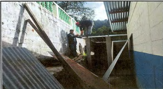
Foto 1: Lámina: sustitución de lamina se encuentra en mal estado oxidada y con agujeros
