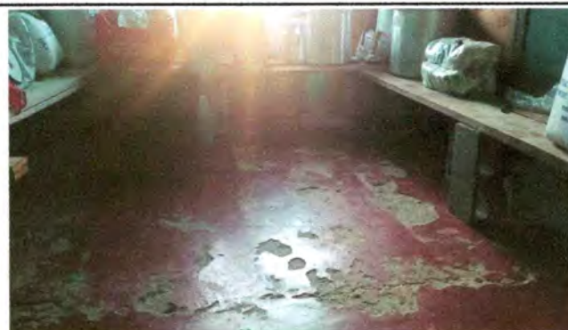
Foto 4: Pisos: agrietamiento en el piso rustico
