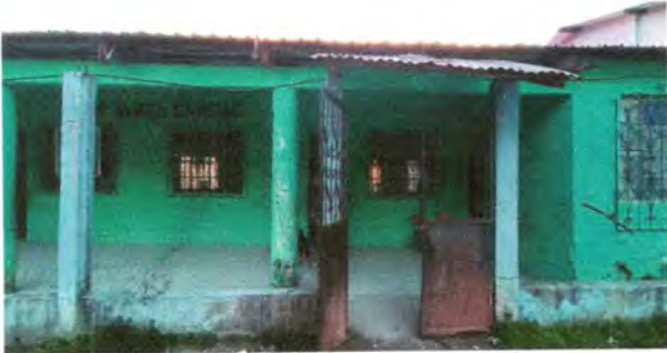
Foto 7: Porton: deterioro de porton
