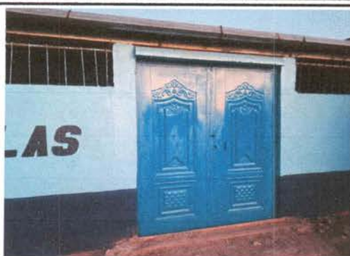
Foto 2: Sustrucción de Portón.
