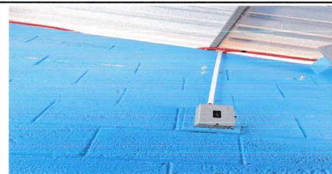
Foto 6: Sustrucción de cableado eléctrico.
