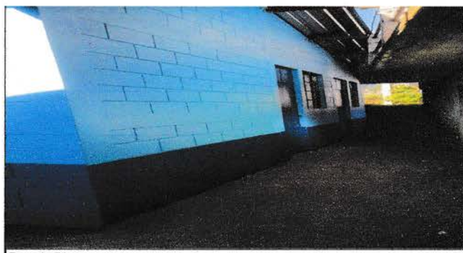
Foto 6: Pintura en muros exterior
