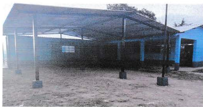
Foto 1: Sustrucción de cubierta de lamina
